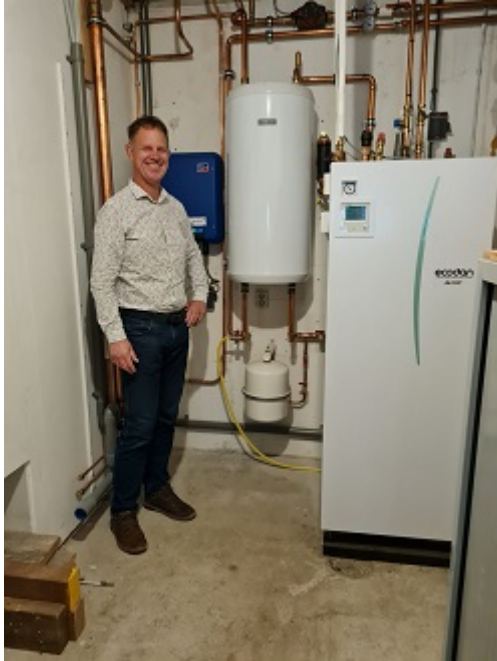
Erwin bij de warmtepomp
