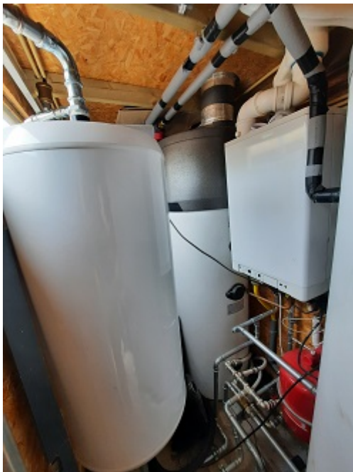
Warmtepomp Valerius Boutique Hotel
