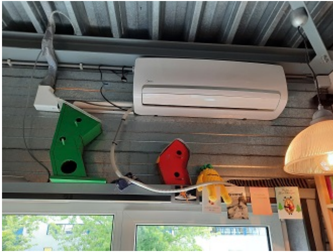
Warmte-koeling unit kantoor Pablo Calle
