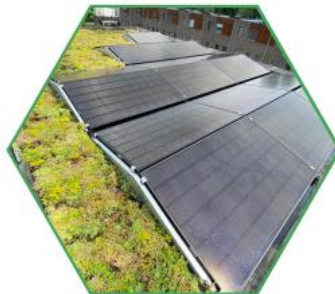
duurzame energieopwekking/buffering van energie
