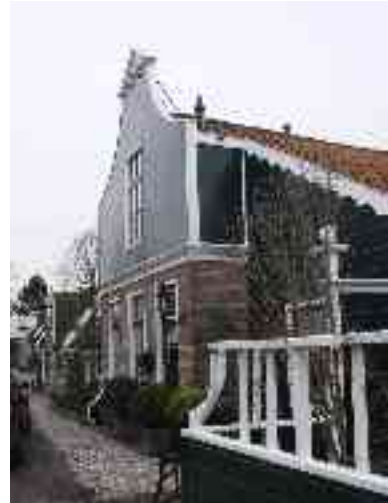
een eenvoudige, maar zorgvuldige detailering van kozijnen, daklijsten, regenpijpen e.d. is vereist
