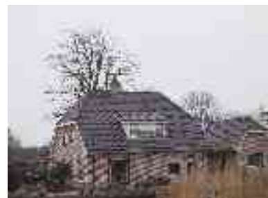
een wolfseind is niet toegestaan
